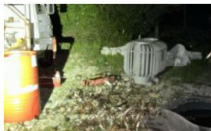
L'esterno della cabina elettrica presenta in via dei Garofani dove l'uomo è stato trovato folgorato
