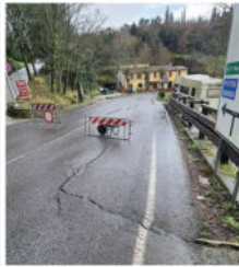
Le fratture sull'asfalto della strada
