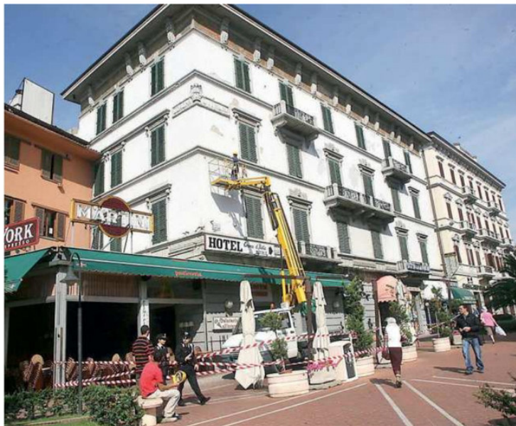
Nella foto di Nucci l'hotel Corona d'Italia sopra il bar Biondi: l'immagine si riferisce al 2007, durante una operazione di messa in sicurezza dopo il crollo di alcuni calcinacci dalla facciata esterna dell'albergo
